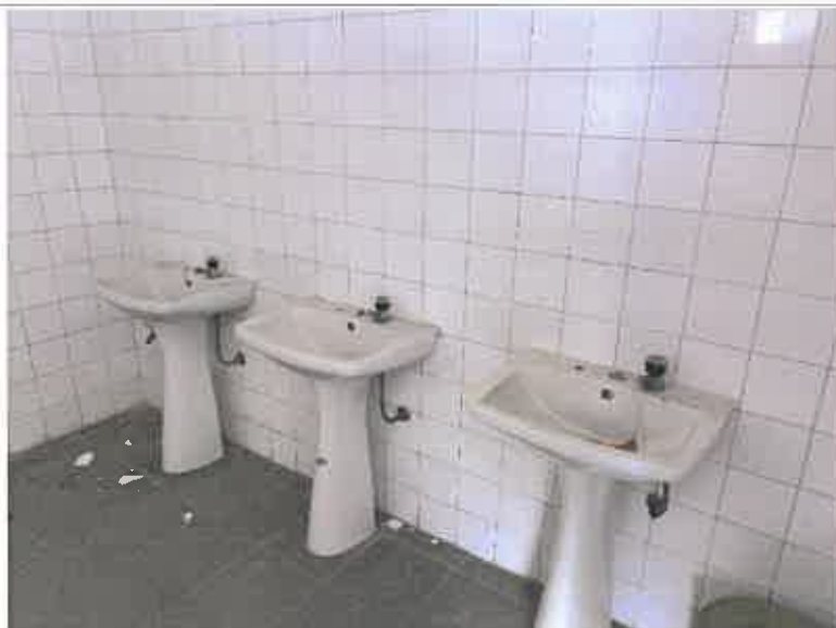
Fotografia 6 – Lavatórios com torneiras não temporizadas
